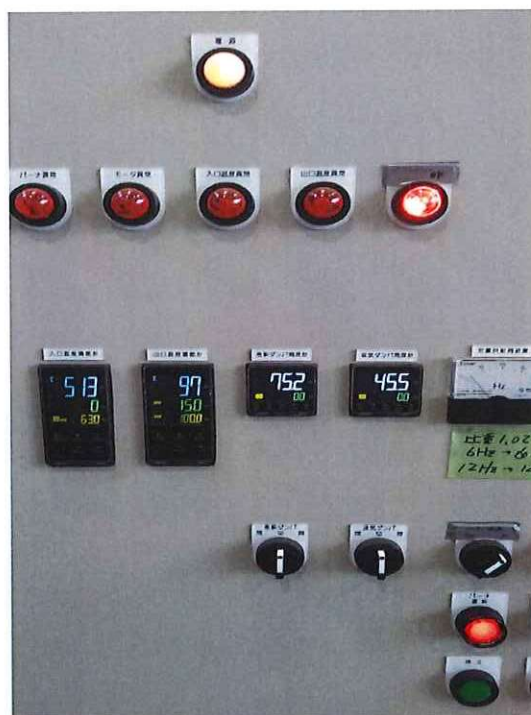
運転時制御盤
