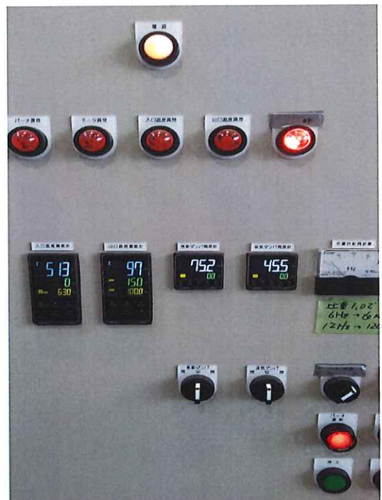
運転時制御盤
